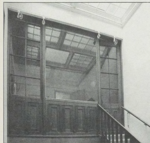
Abb. 7 Treppenhaus, die von Hablik entworfene verglaste Abschlusswand im Obergeschoss, Zustand 2006 (Foto: Barthel)
